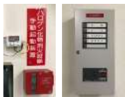
ハウジングルーム 소화設備
