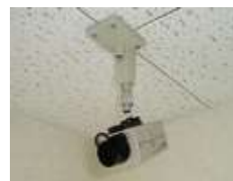
屋内外12箇所 設置カメラ
