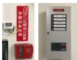
ハウジングルーム 소화設備
