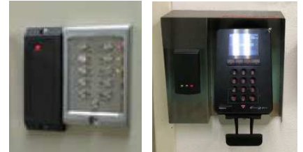
ICカード・暗証番号キー 静脈認証、入退出チェック
