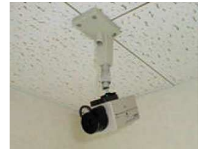
屋内外12箇所 設置カメラ
