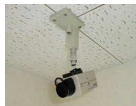
屋内外12箇所 設置カメラ
