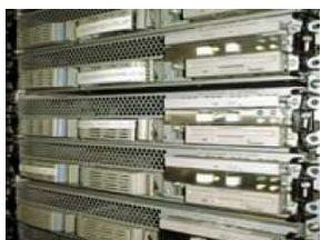
サーバラックの 実装状況
