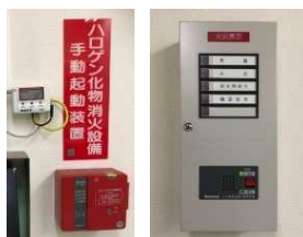
ハウジングルーム 消化設備
